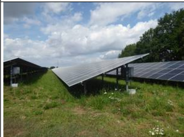
Foto 5: Modulreihen im Westteil des Solarparks (Foto: Wiesner, 13.7.23)
